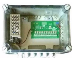
Trafo 220V / 9V
